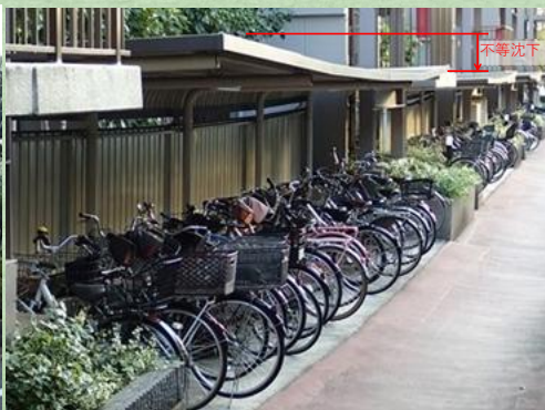
写真3 駐輪場の不等沈下
