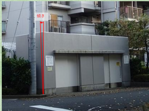
写真1 構造物の傾斜
